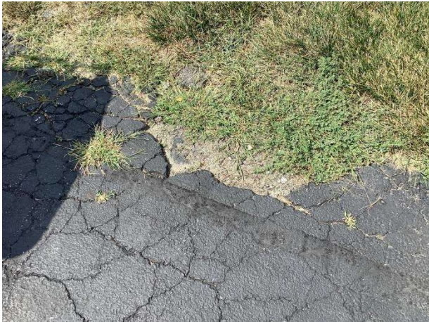
Periodic edge deterioration
